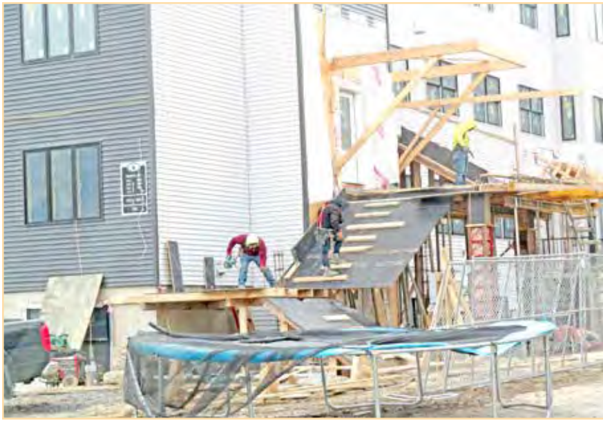
ליוולענד' 6 אוהעל קט. אונטער א יאר זינט מען האט אנגעהויבן גראבן פאנדעישאן, טרעפ ווערט געגאסן פאר די נייע דירות
