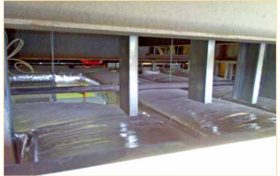
עקזאסט דוקס אינסטאלירט
